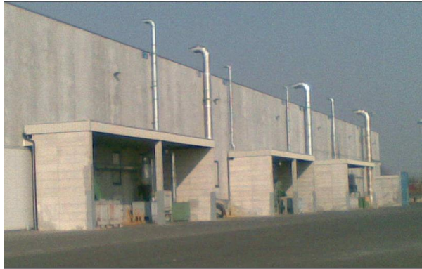
Un gruppo di impianti di aspirazione/filtrazione aria e da una torre di raffreddamento
