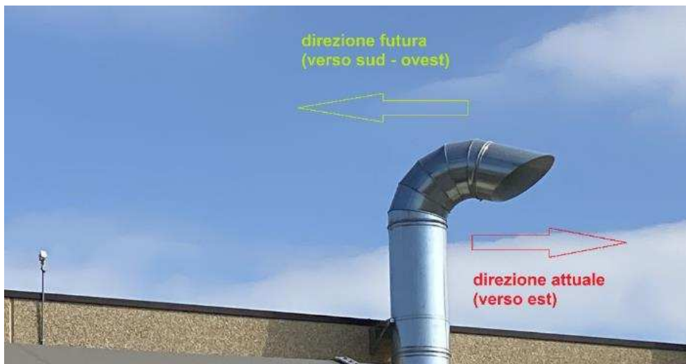
Emissione in atmosfera dell'attuale verniciatura (alla quale sarà affiancato il nuovo camino)
